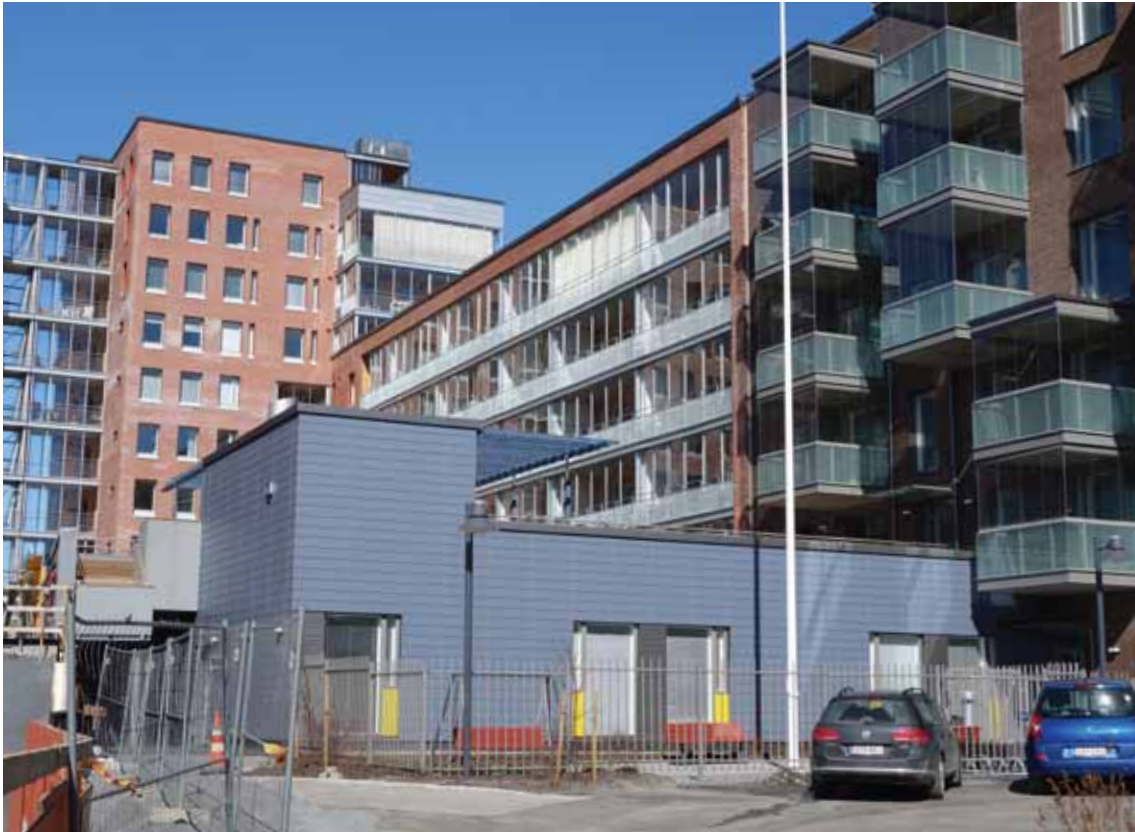
Ensimmäisenä kaukojäähdytykseen liitettiin syyskuussa 2012 As. Oy Tampereen Baana, joka on Ratinassa sijaitseva uusi asuinkiinteistö, kuva rakennusvaiheesta.
