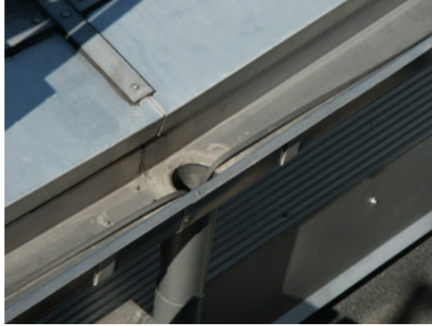
Kuva 4. Sulamisvesien poisto sähkölämmitteistä kourua ja ränniä myöten.
