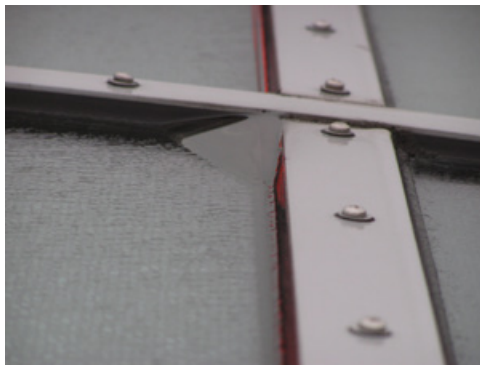
Kuva 9. Lasien kiinnityslistat ja veden kerääntymisen niiden taakse.
