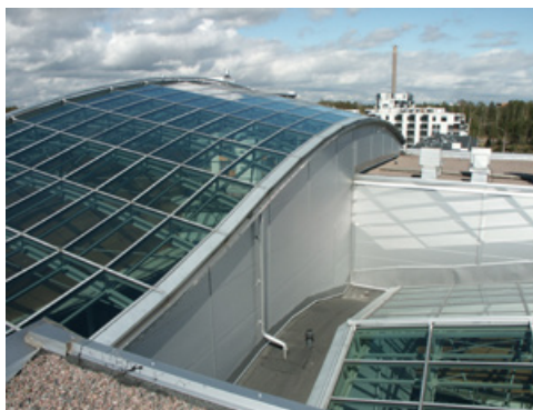
Kuva 8. Lasikatolta lumi putoaa umpikaton päälle.
