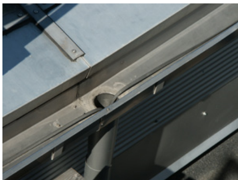
Kuva 7. Sulamisvesien poisto sähkölämmitteistä kourua ja ränniä myöten.
