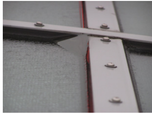
Kuva 12. Lasien kiinnityslistat ja veden kerääntyminen niiden taakse.
